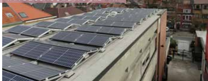
ZONNEPANELEN OP HET DAK VAN DE SCHOOL LA FUTAIE
