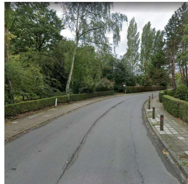
Photo 7 : Etat des revêtements Foto 7: Staat van overkappingen
