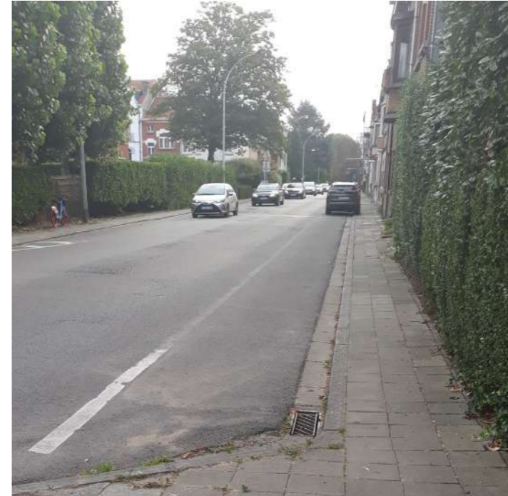
Photo 3 : Etat des revêtements Foto 3: Staat van overkappingen
